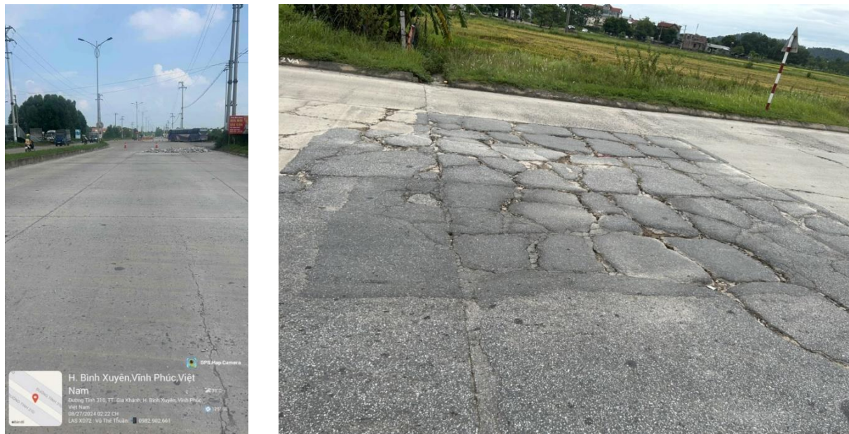
Hình 2. Hiện trạng mặt đường BTXM trên đoạn tuyến
