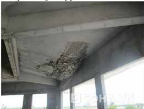
Hình 2. Hư hỏng công trình do tải trọng vượt quá quy định thiết kế
