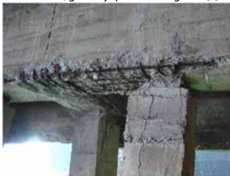
Hình 3. Bê tông bị hở cốt thép do ăn mòn hóa học
