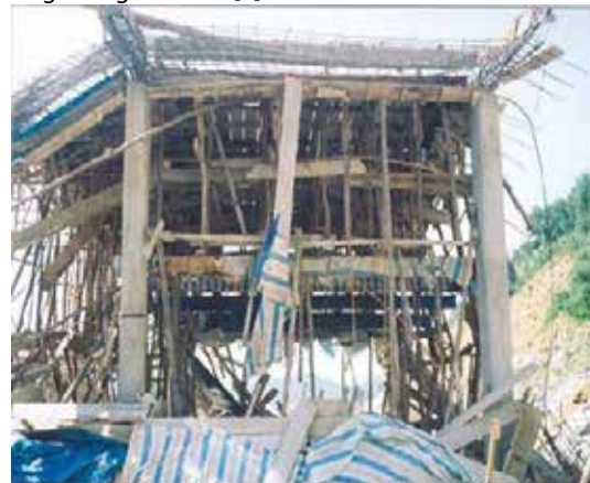
Hình 1. Sập công trình do thiết kế giàn giáo không đủ tải trọng
