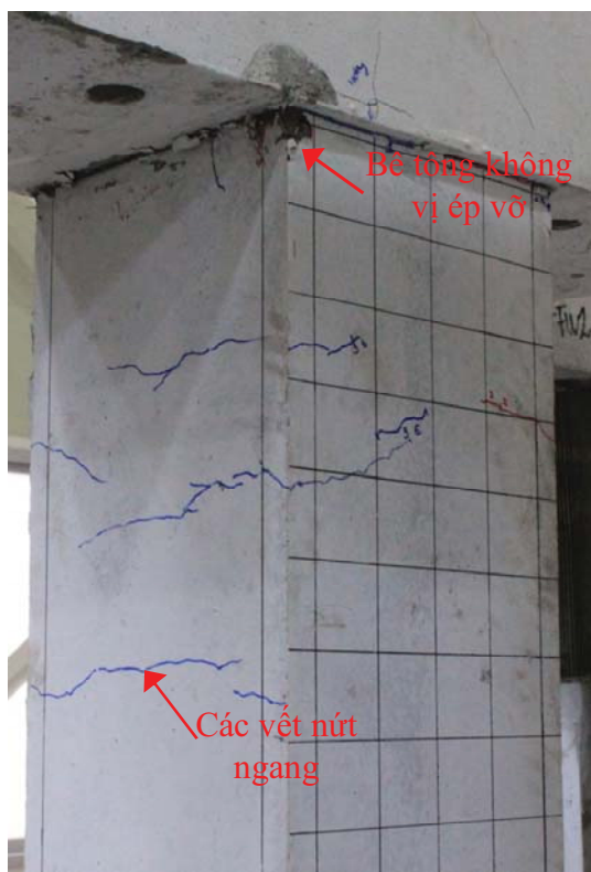
Hình 8. Đặc điểm hình thái phá hoại của mẫu được gia cường
